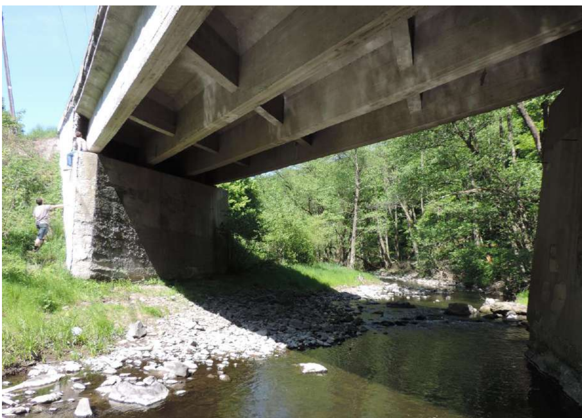
Obrázok č. 1.17: Most v lokalite Krišovský mlyn, významný úkryt podkovárov malých je dnes v oprave a ochrane podmostového priestoru treba venovať značnú pozornosť
